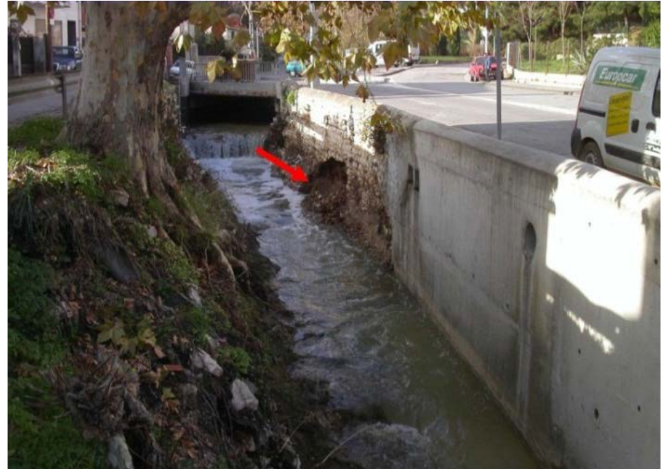
Effondrement d'un mur de soutènement
